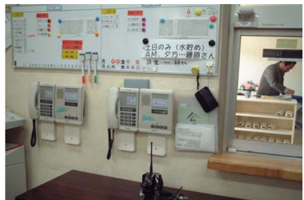
写真3. コミュニティプラザに設置されたLSA室
